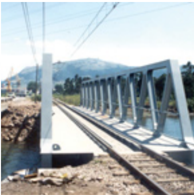
La Pereda, Spanyolország. F.E.V.E. vasúti híd. Az 54 rendszerű nagyvasúti sín folytonos ágyazása, teljes kiöntése a léghangkibocsátást minimálisra csökkentette.
