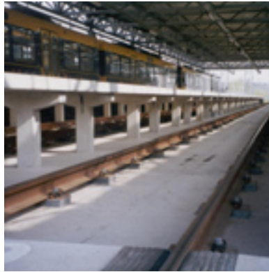
Remsecker üzemcsarnok, Stuttgarter Villamosvasút. Tőcsavarok nélküli közvetlen ragasztott sínleerősítés. Az Rph 360 × 210 mm-es, lehorgonyzó csavarok nélkül leragasztott alátétlemekkel sok időt és költséget takarítottak meg.
